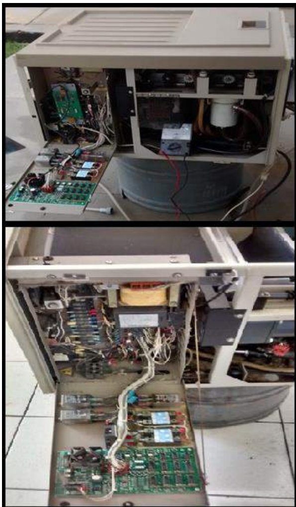
Figura 3: Painel elétrico e o painel de fusíveis da PA2.
